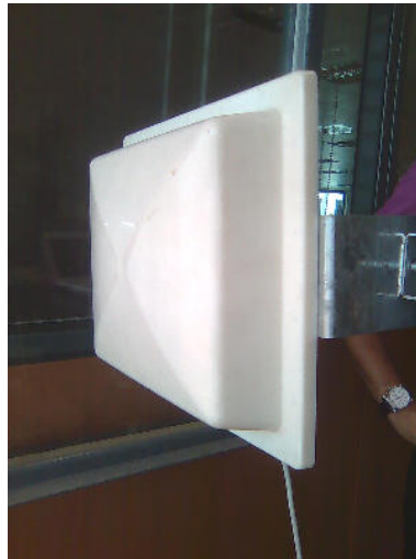
Detalle estación base y herrajes
