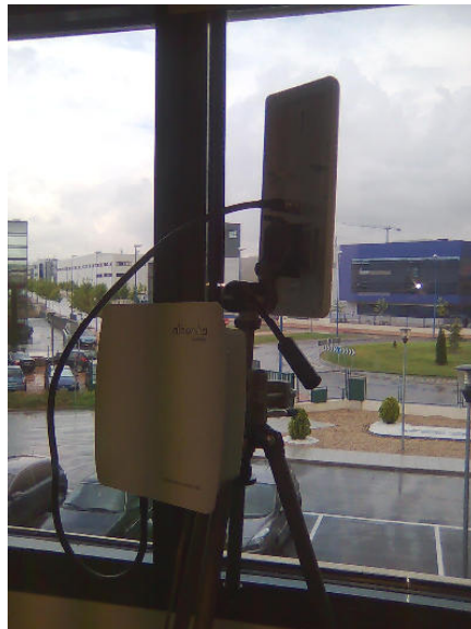
Detalle estación base WIMAX y antena asociada sobre trípode
