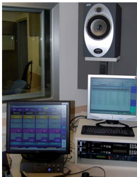
La radio pública vasca mantiene continuamente en activo un total de 32 consolas RDSI gestionadas desde este Systel 6000
